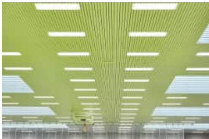
S-85 Deckenstrahlheizung - Spitzentechnik für Wärme, Kälte und Akustik, gepaart mit hervorragender Optik
