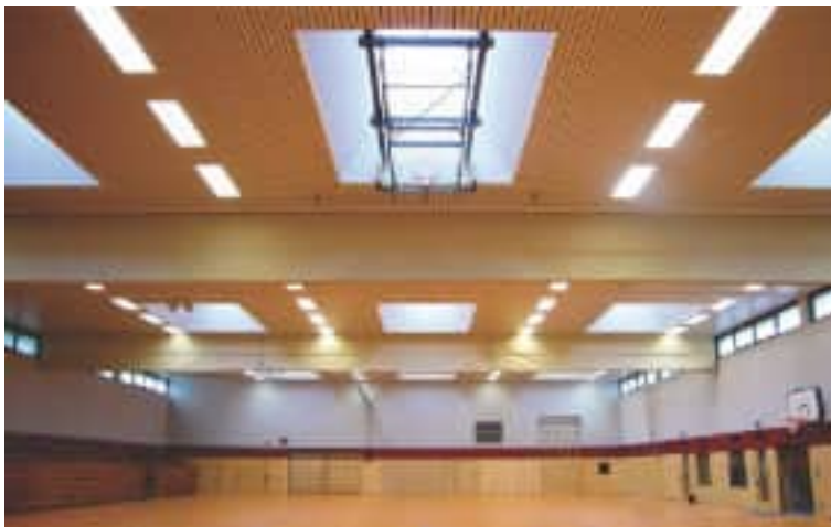
Vollflächige Deckenstrahlungsheizung von Wand zu Wand
